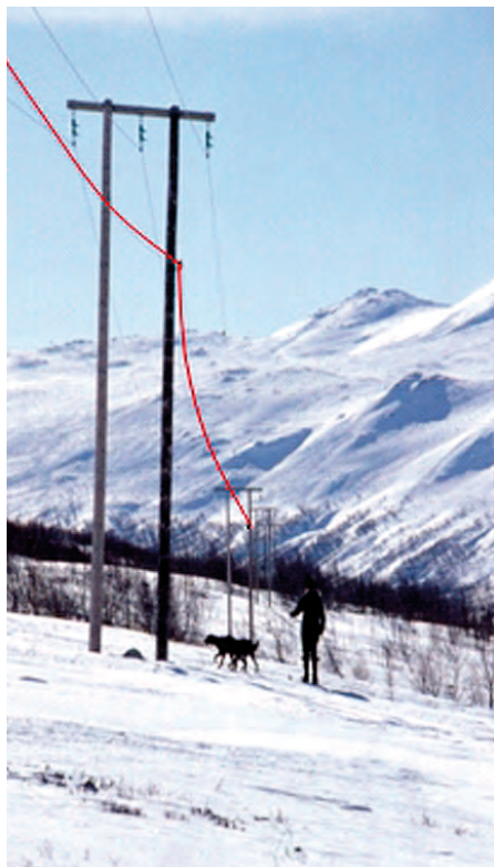
Kraftledning med underliggende jordline markert med rødt.
