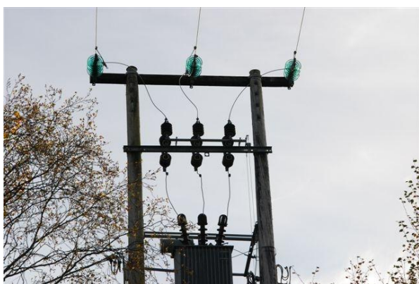
Bilde 5.1.2 viser trafo på kartbladet
