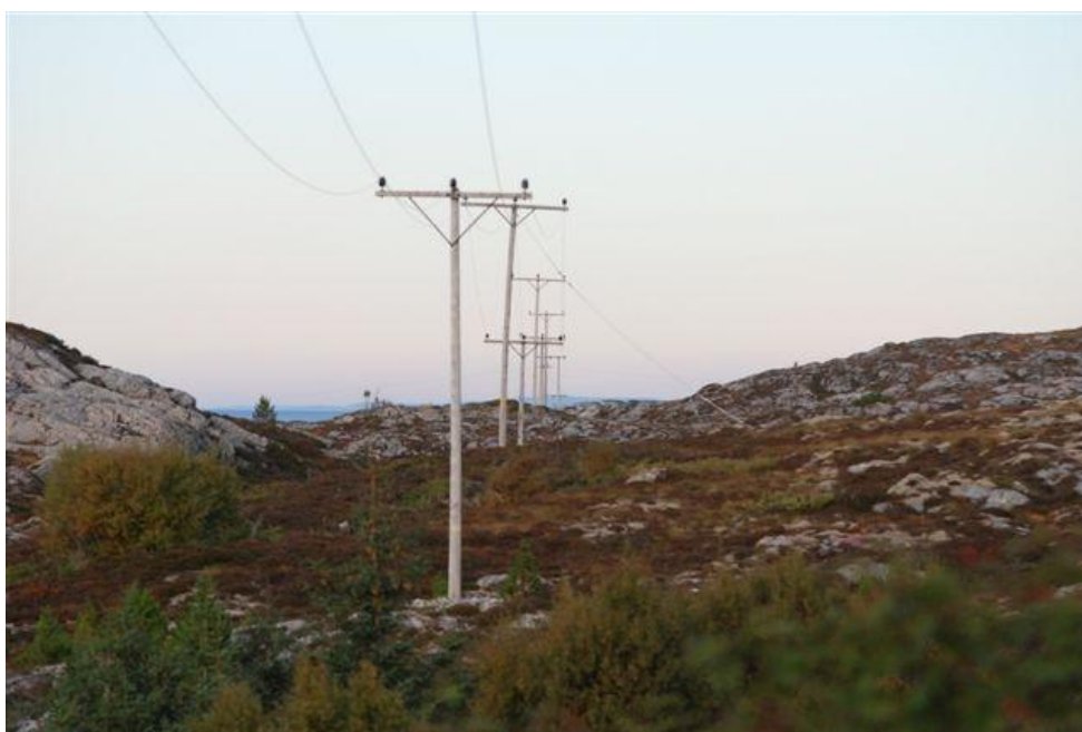
Bildet 4.1.5 viser linjestrekk og punkt 2 på kartet. Denne linjestrekningen skal bygges om til to meter faseavstand i løpet av 2011/2012 (Per Espnes pers.med.). I fall vil dette føre til betydelig mindre risiko for elektrokusjon i distriktets beste hubrorevir.
